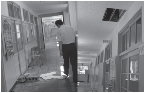
photo.03 ガラスの散乱する 理科実験室(2011年7月)
